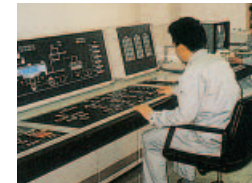
工業用浄水場管理
