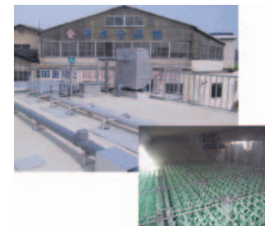
河本食品(株)排水処理施設（和歌山県）
